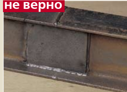
Соединение в T-образной балке дополнительно укреплено накладкой – абсолютно неверно!
