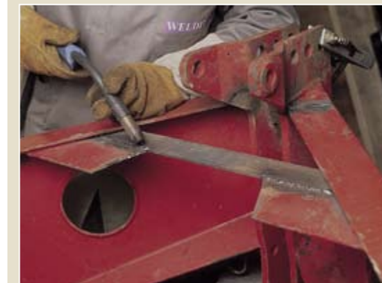
Старайтесь сделать сварной шов как можно более длинным, это необходимо для распределения нагрузок. В противном случае, короткий шов окажется слабым местом конструкции.
