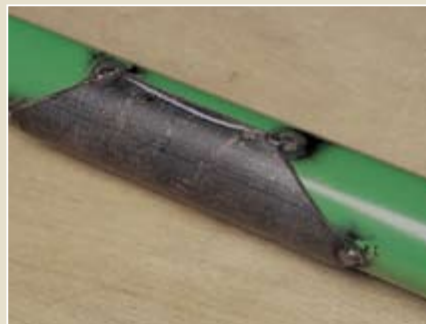
Треснувшая труба также ремонтируется заостренными усиливающими пластинами.
