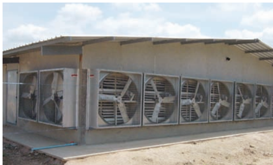
Рис 19: Пример автоматической вентиляции
